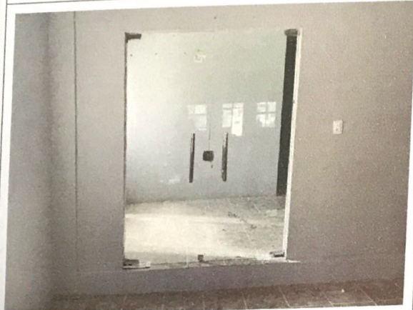
FOTO 3: PORTA DE ABRIR EM VIDRO TEMPERADO;
